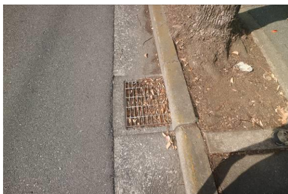
落葉による排水施設の詰まり
