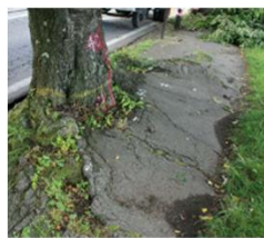
道路空間再編にあたっての植栽帯の狭小化による根上り
